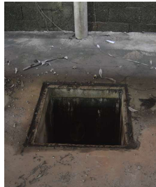
IMAGEM 14: Caixa de Inspeção sem tampa. Foto do Autor, 2019.
