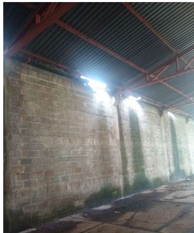
IMAGEM 13: Parede que separa as duas naves. Todas as calhas estão deterioradas despejando água para o espaço interno. Foto do Autor, 2019.
